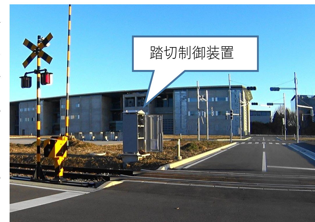
踏切制御装置
